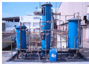
Equipamento de desmineralização de água.
